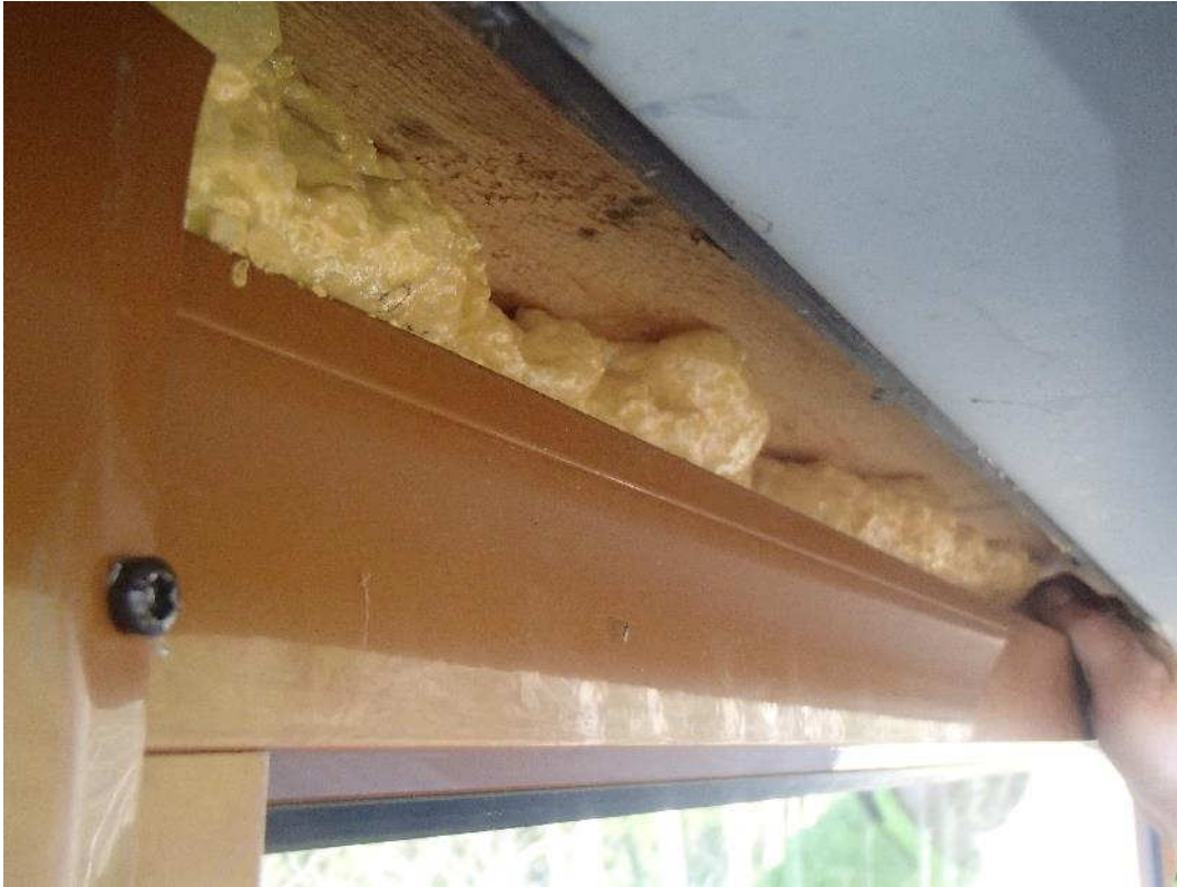
Kuva 106. Liikuntasalin ikkunoiden yläosien pellitykset ovat puutteelliset, mutta rakenne on suojassa suoralta sateelta.
