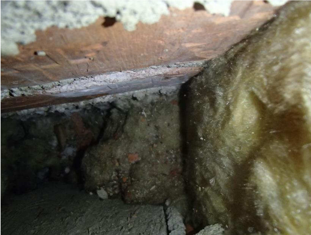
Kuva 19. Luokkahuoneen 7 eristetilassa oli paikoin alueita, jolla ei havaittu eristeitä.
