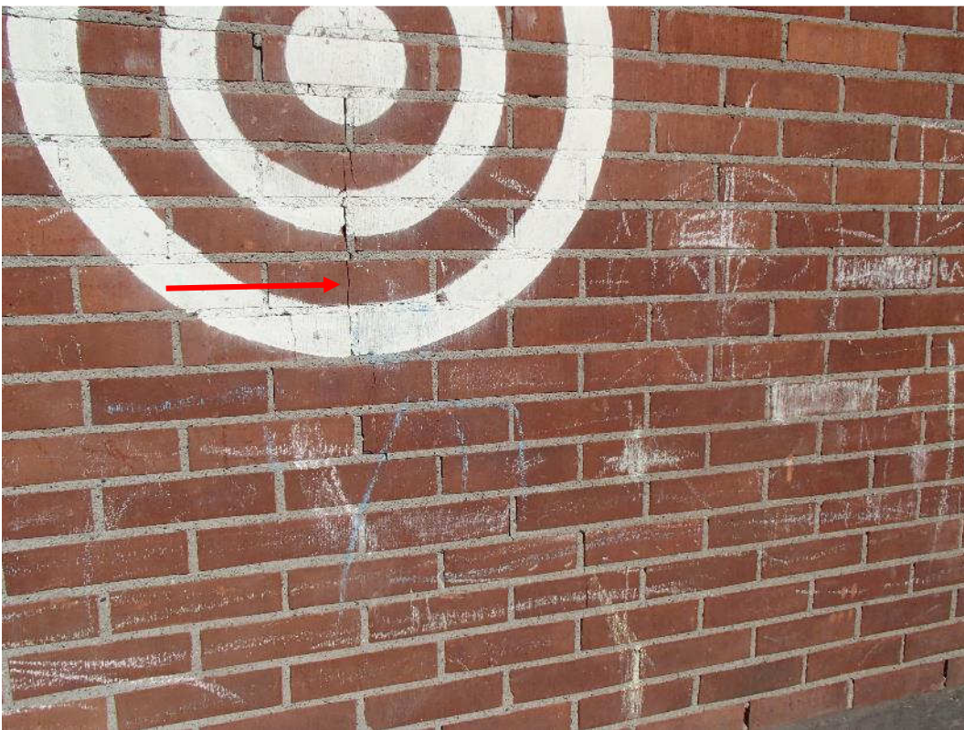
Kuva 105. Tiilimuurauksessa havaittiin halkeilua.
