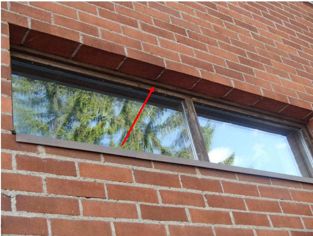
Kuva 107. Liikuntasalirakennuksen ikkunoiden liitokset tiilimuuraukseen ovat avonaiset.
