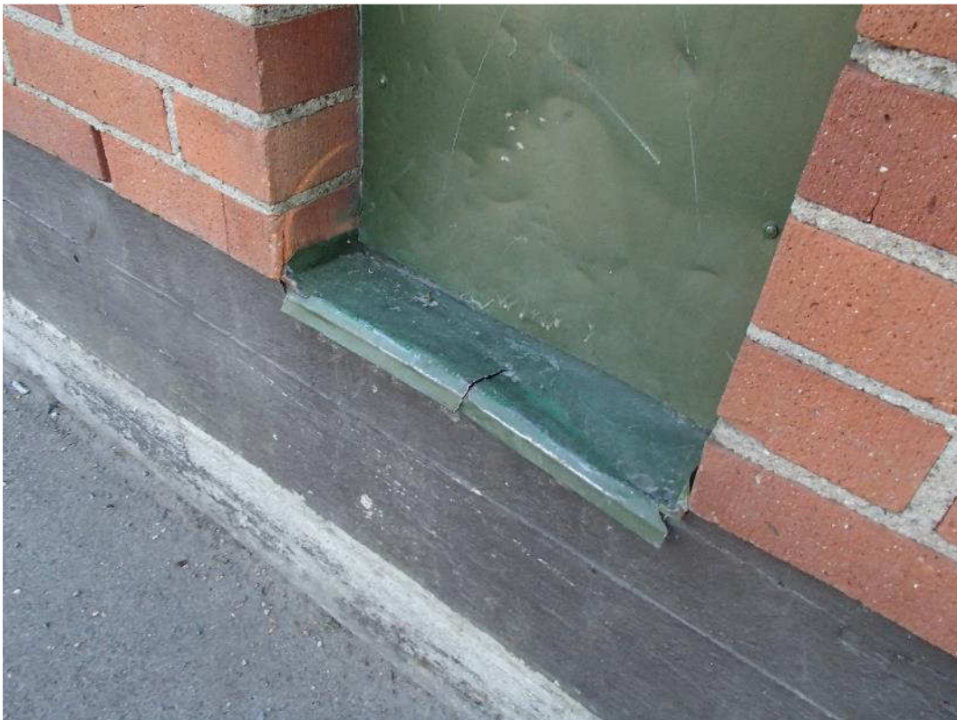
Kuva 103. Paikoin vesipellitykset ovat vaurioituneet.
