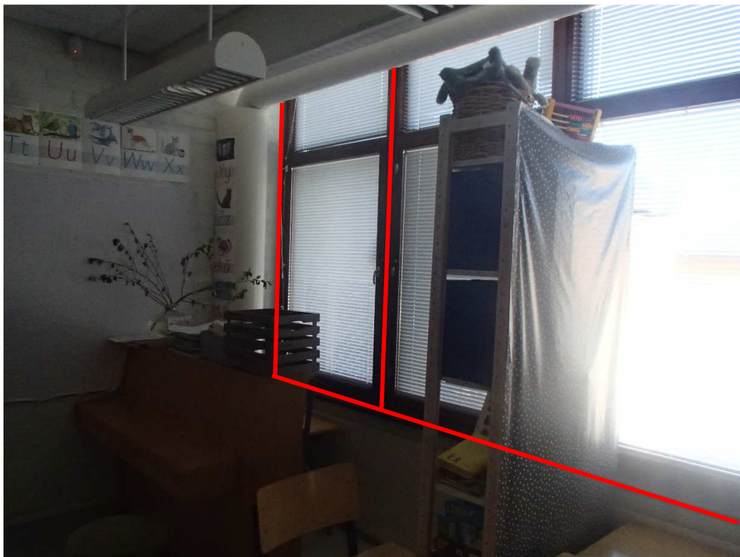
Kuva 159. Luokan 51 tyypillisimmät epätiiveyskohdat.
