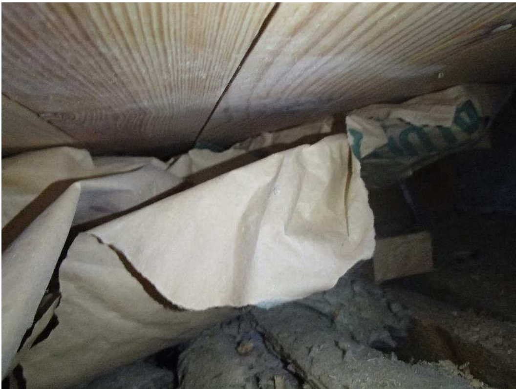
Kuva 91. Kotitalousluokan eristetilassa havaittiin rakennusaikaista puujäänteitä ja rakennuspapereita.
