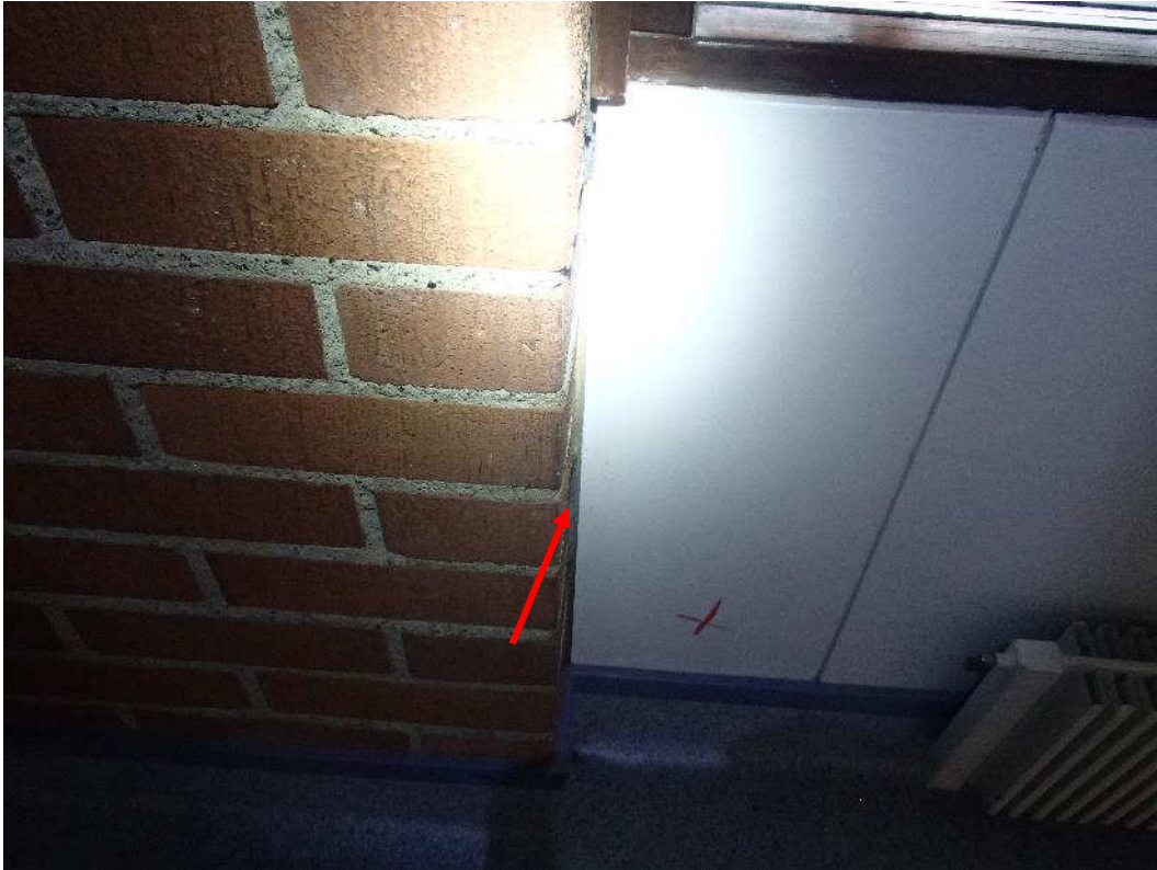
Kuva 47. Valopihan sisäseinien ja vanhojen julkisivujen rajapinnalla on rakoja, joista on eristetilasta suora ilmayhteys käytävään.
