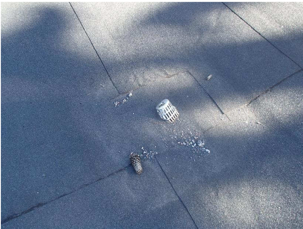
Kuva 65. Osa kattokaivoista on vaurioitunut.
