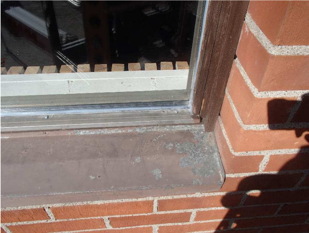
Kuva 108. Ikkunoiden ja vesipeltien maalipinnat ovat ikääntyneet.
