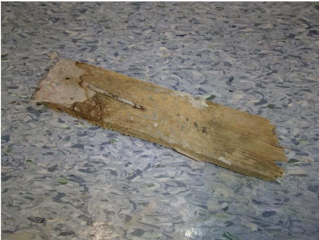
Kuva 87. Alapohjan pintalaatan alapuolella havaittiin rakennusaikaisia puun palasia.
