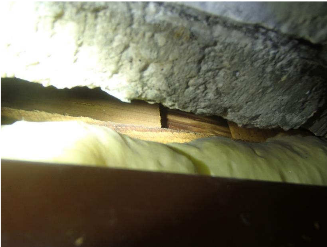
Kuva 20. Luokkahuoneiden ikkunoiden yläosissa havaittiin eristepuutoksia.
