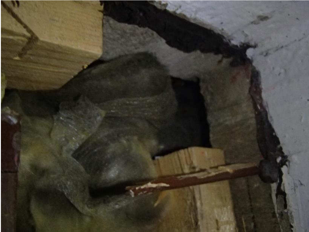
Kuva 13. Rakenteiden rajapinnoilla havaittiin eristeissä tummentumista.
