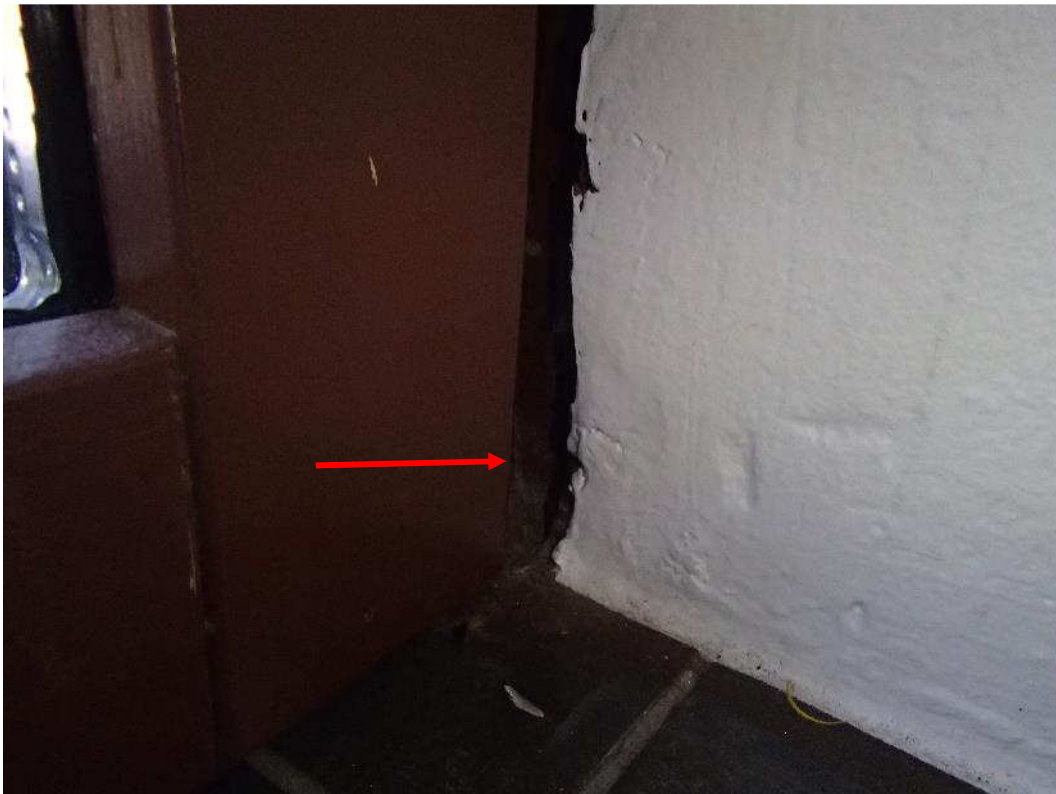
Kuva 119. Tiilimuurausten ja ikkunarakenteiden välisistä havaittiin suoria ilmayhteyksiä eristetilaan.
