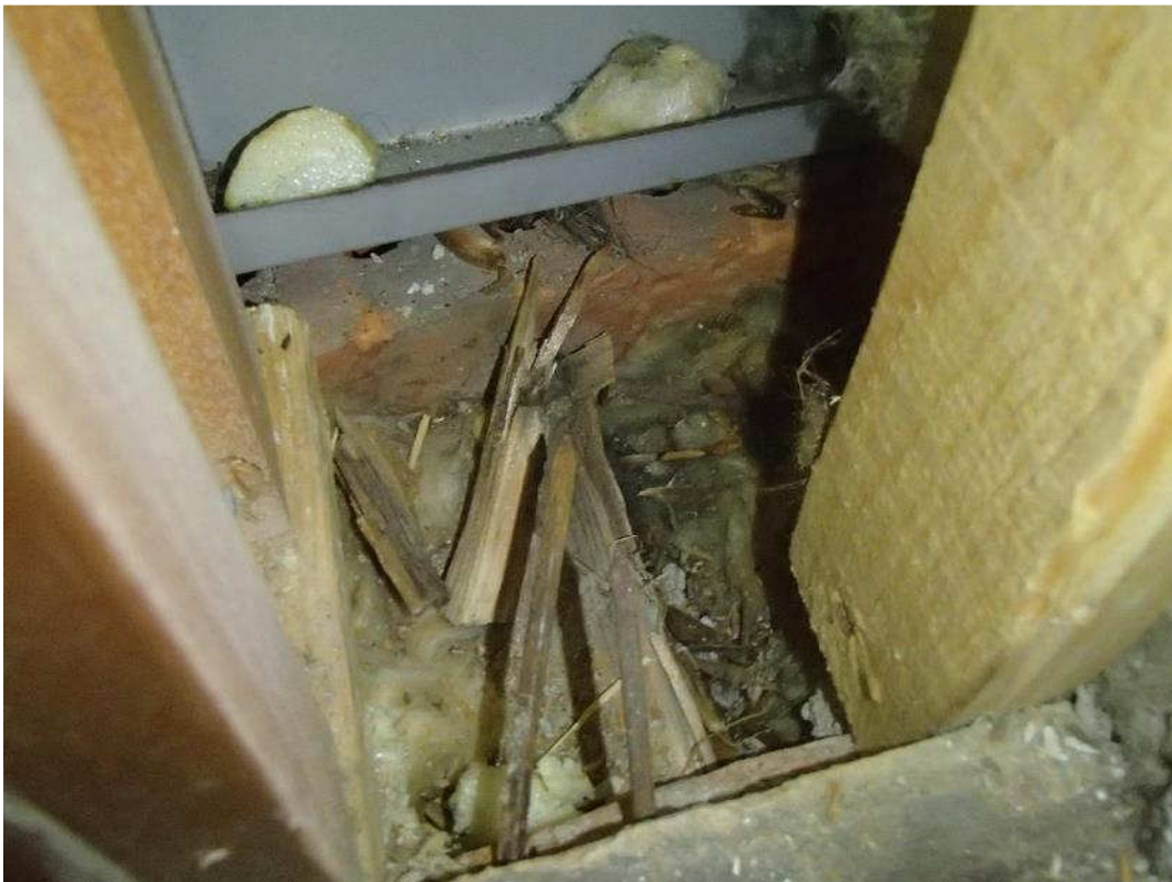
Kuva 12. Julkisivujen eristetilassa havaittiin lahonnutta puumateriaalia.
