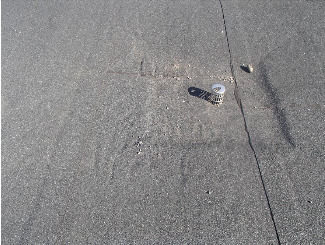
Kuva 60. Vesikatteessa havaittiin paikoin poimuuntumista.
