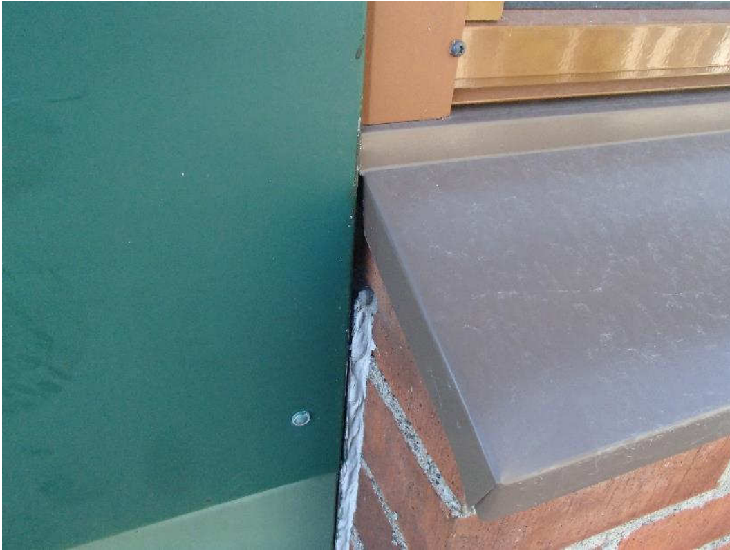
Kuva 102. Julkisivupellityksien ja muurauksen väliset elastiset saumamassat ovat ikääntyneet.
