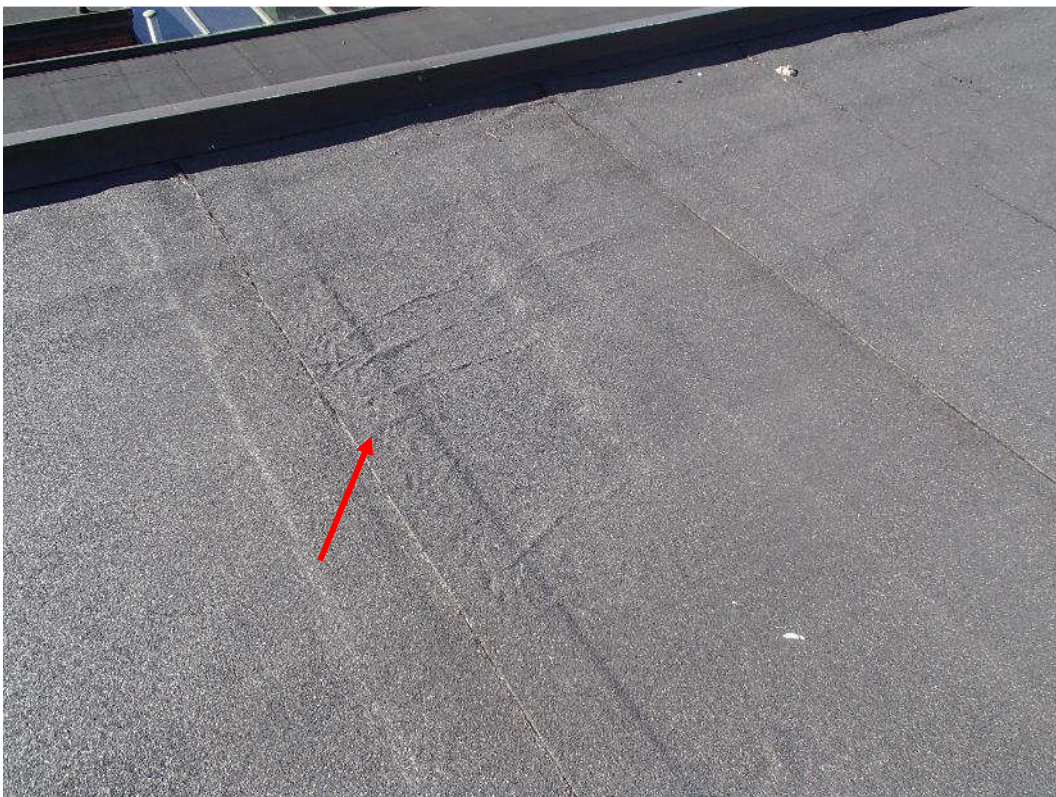
Kuva 59. Vesikatteessa havaittiin paikoin poimuuntumista.
