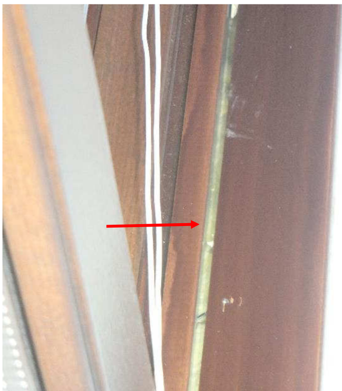
Kuva 121. Tiilimuurausten ja ikkunarakenteiden välisistä havaittiin suoria ilmayhteyksiä eristettiin.
