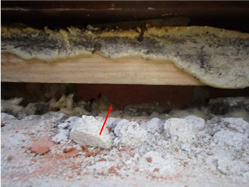
Kuva 41. Valopihan ikkunoiden apukarmin alapuolella eristevajausta.
