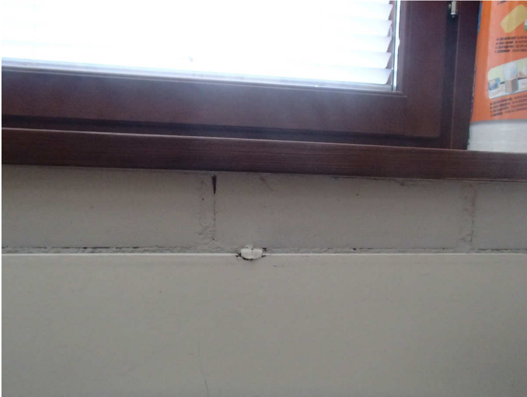
Kuva 160. Ilmavuotoja havaittiin myös tiilimuurauksen saumoista luokassa 51.
