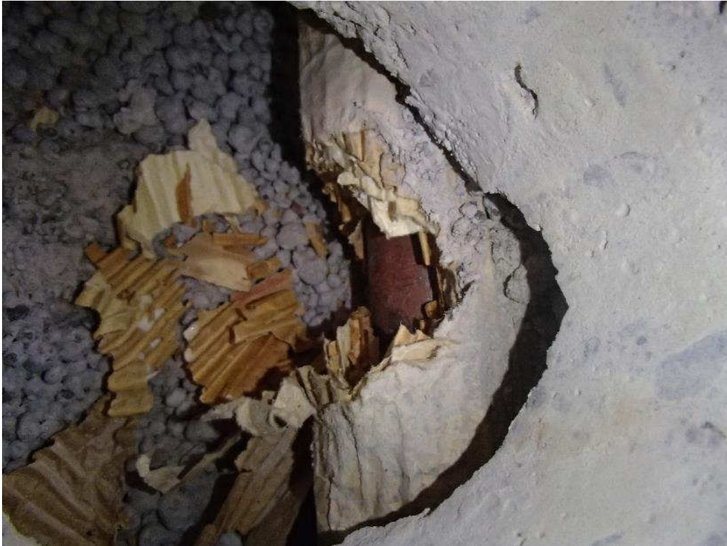
Kuva 88. Lämmitysputkisto on eristetty aaltopahvilla.
