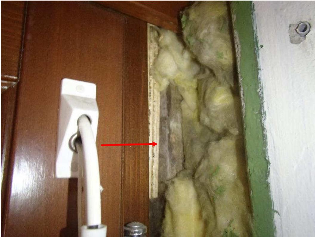
Kuva 118. Tiilimuurausten ja ikkunarakenteiden välisissä eristeissä havaittiin tummentumista ja apukarmeissa kosteusrasitukseen viittaavia tekijöitä.
