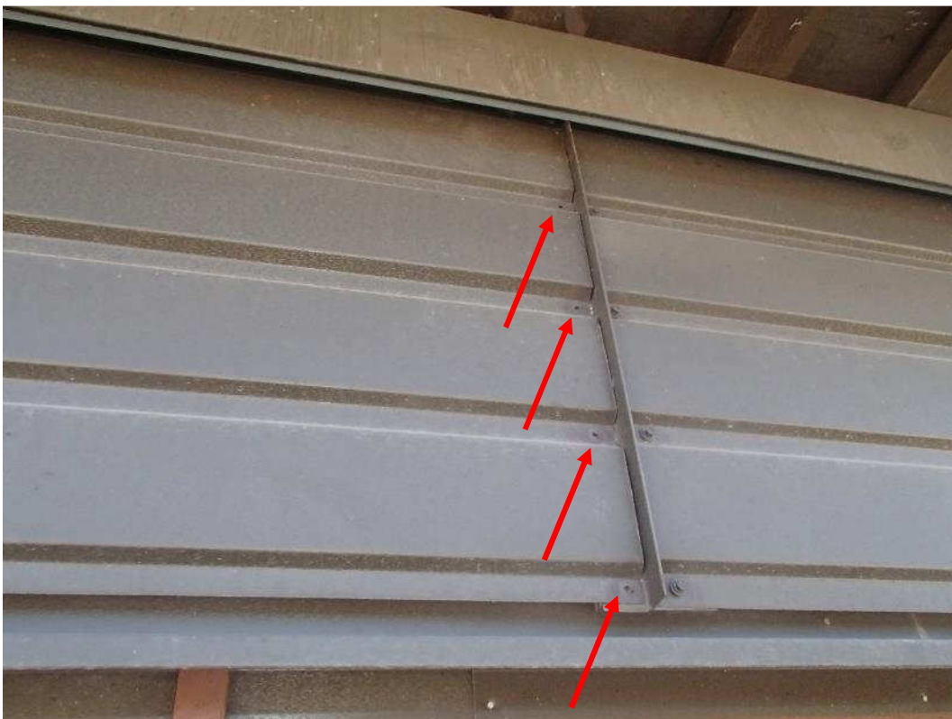
Kuva 22. Julkisivujen profiilipellityksistä on irronnut kiinnitysruuveja.
