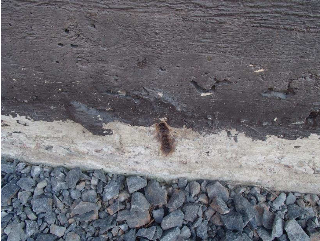
Kuva 28. Sokkelissa havaittiin betoniteräsvaurioita.
