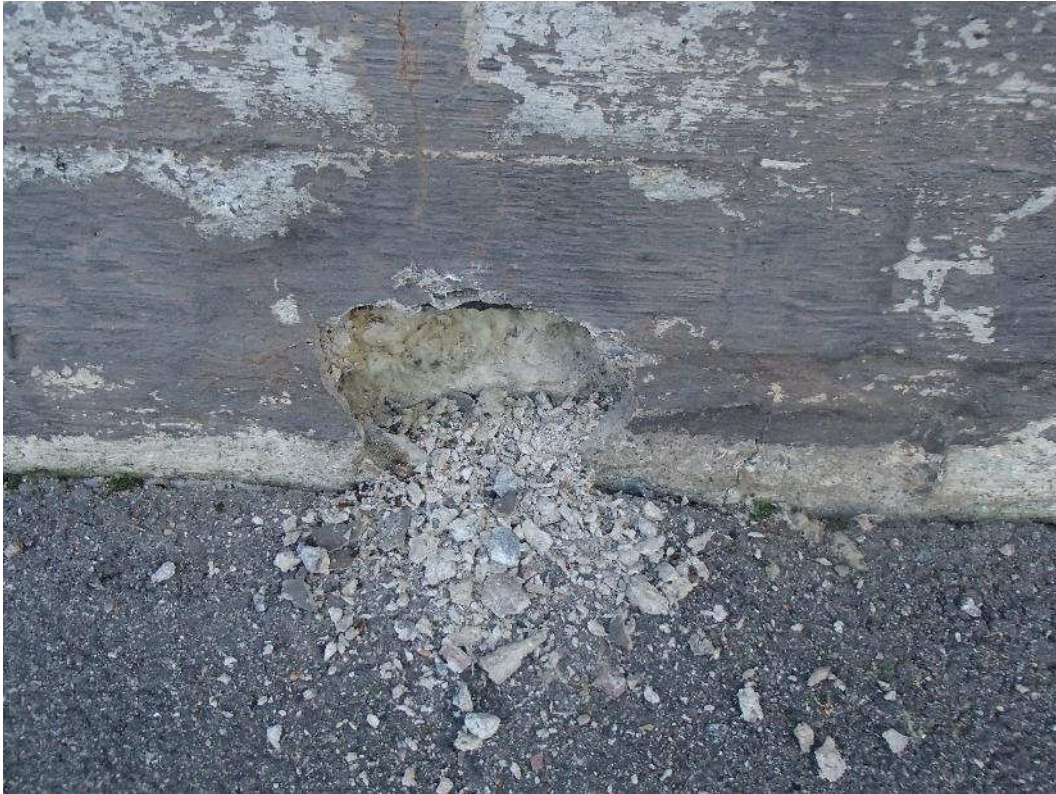
Kuva 114. Paikoin sokkelin suojabetonikerros on puutteellinen ja mineraalivillaeristeet ovat esillä.
