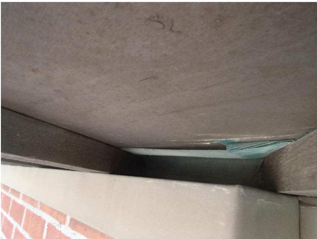
Kuva 70. Tuuletusraon hyönteisverkot ovat paikoin irronneet kiinnityksestään.
