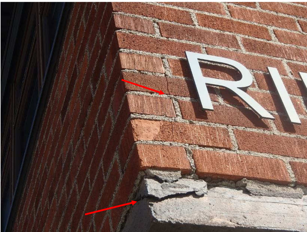
Kuva 10. Tiilimuurauksessa ja betonirakenteissa havaittiin halkeilua ja irtoilevia kappaleita.
