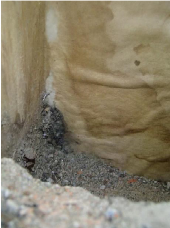
Kuva 45. Valopihan kevytrakenteisen seinän alaosissa havaittiin kosteusvaurioita rakennuspaperissa.
